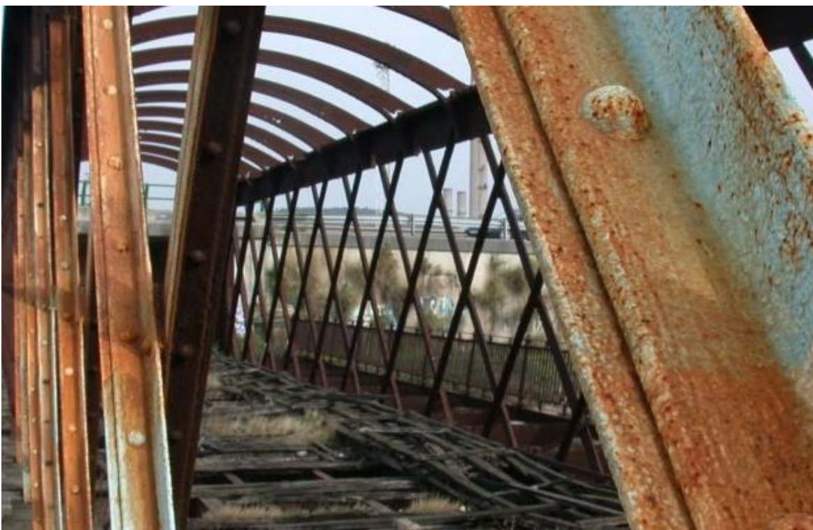
Figura 6 - Estrutura Metálica Enferrujada.
